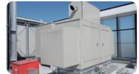
自家発電設備
