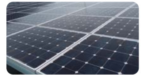
屋上の太陽光パネル
