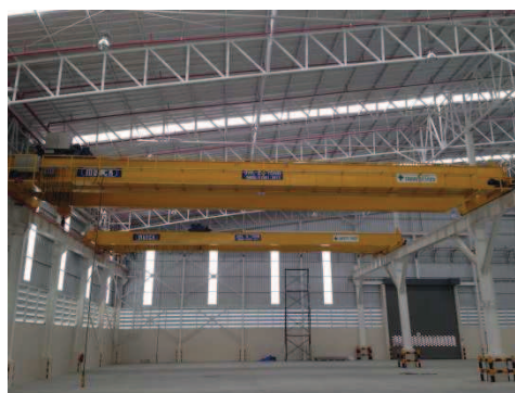
倉庫内天井クレーン (手前 25t, 奥側 5t)
