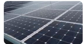
屋上の太陽光パネル
