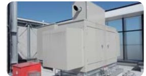
自家発電設備
