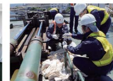
油流出防止のため部品を交換
